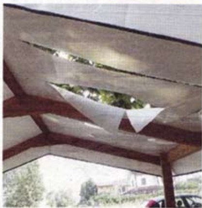
VILLAGGIO PERLA La copertura del gazebo lacerata dai vandali
